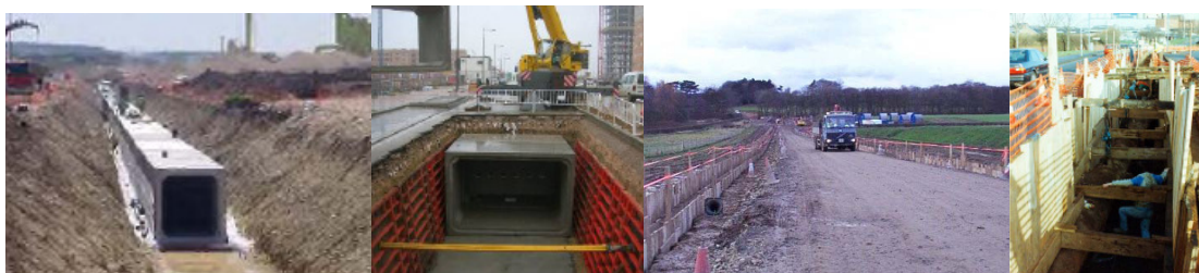
Foto 4 – Exemples d'instal·lació en calaix i en rasa de cables soterrats en zones urbanes i zones rurals de cables soterrats similars. Font: [13], [15] i [18].
